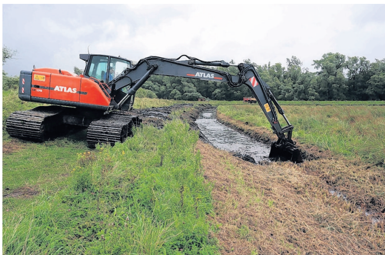
▲ Langzaam maar zeker wordt de sloot weer zichtbaar, dankzij de inzet van een kraan.
